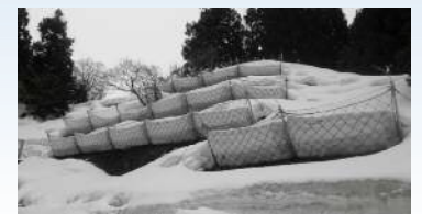
雪崩予防柵 ARCフェンスタイプ
