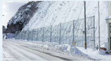
雪崩防護柵 スロープガードフェンス タイプ LS NETIS登録番号：HR-100008-VR
