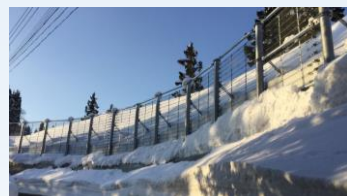
雪崩防護柵 スロープガードフェンス® タイプ LS NETIS登録番号：HR-100008-VR
